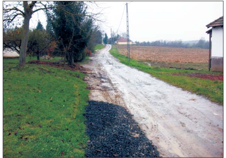
A villany és a víz után az út javítása következik.
